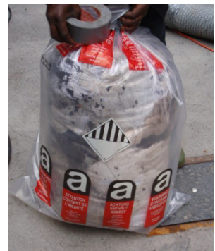
4 Kunststoffsack mit der Kennzeichnung Asbest
