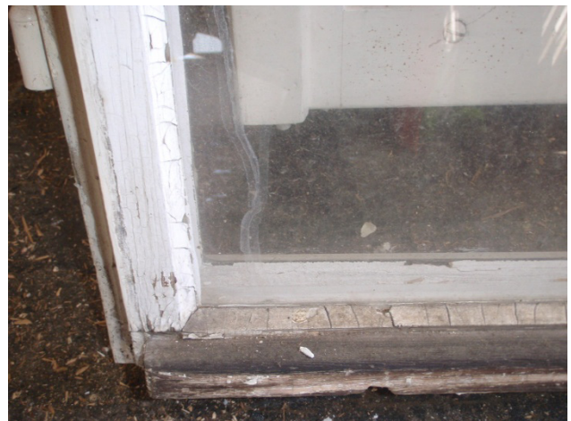
1 Asbesthaltiger Leinölkitt an einem Holzfenster
